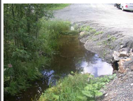
Pt 4: érosion de la route coin Sud-Ouest de l'intersection
