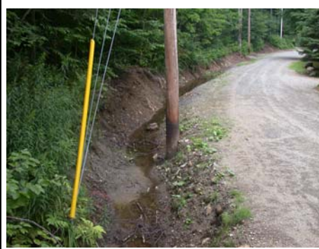
Trib1 pt.2: érosion du talus de fossé
