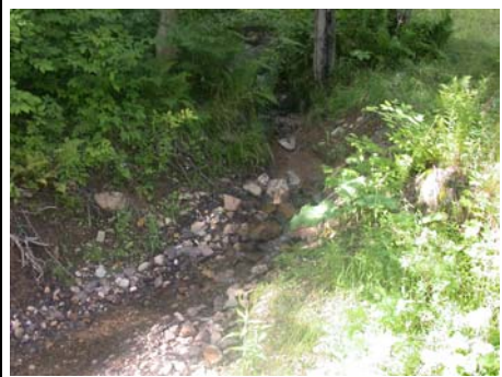
Pt 2: érosion de fossé
