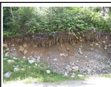
Jack Pt 2 : affaissement de talus
