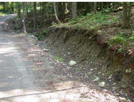
Pt 22: talus érodé sur la rive gauche
