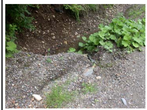
Trib3 pt..2: érosion du ponceau
