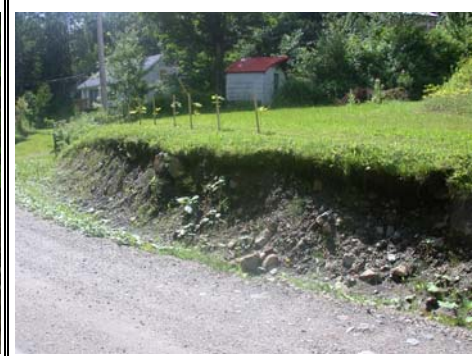
Trib1 pt.7: décrochage du talus
