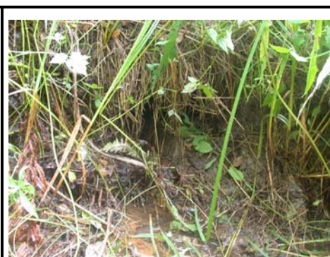
Jack Pt 4 : ponceau obstrué
