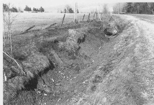
Photographie no 1 : Section nettoyée à l'été 1995 selon la méthode traditionnelle. Cette photographie prise au printemps 1996 permet de constater les effets dévastateurs de l'érosion (solifluxion et décrochage) sur les talus du fossé. (Route 222-01-140, vue vers l'est) (Photo: RAPPEL)
