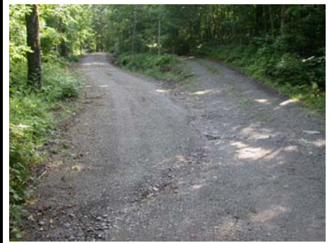
Pt 21: ravinage par ruissellement
