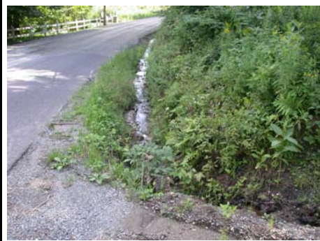
Pt 1: érosion sur route secondaire
