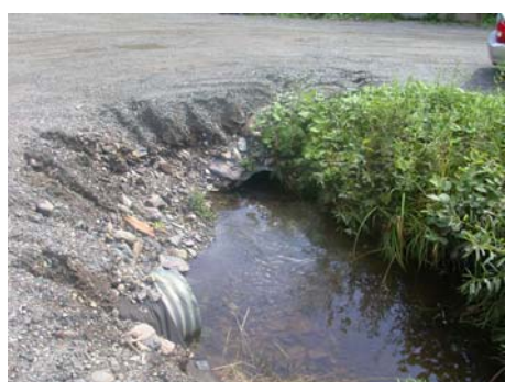
Pt4: érosion de la route coin Nord-Ouest de l'intersection
