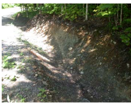
Trib1 pt.6: érosion du talus de fossé
