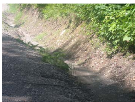
Pt 6: entretien inadéquat du fossé
