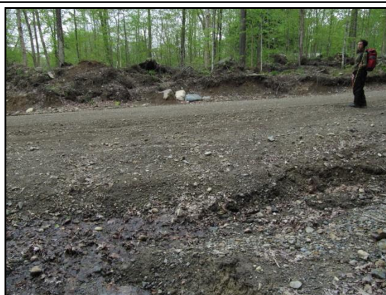
Point 4 : Ravinement du talus et terre à nu.
