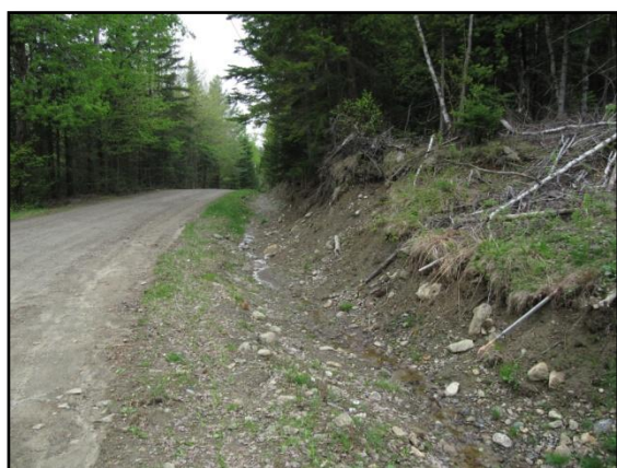
Point 11 : Talus de déblai non végétalisé.
