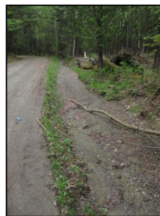
Point 10 : Importante accumulation de gravier causée par l'érosion du fossé.
