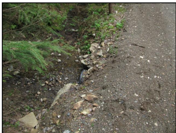
Point 7 : Haut de talus non stabilisé et accumulation de gravier dans le lit du cours d'eau.
