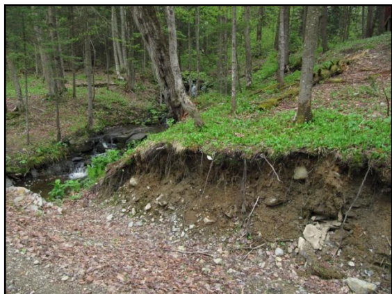
Point 6 : Fossé à nu et surplomb de la couche de sol organique.
