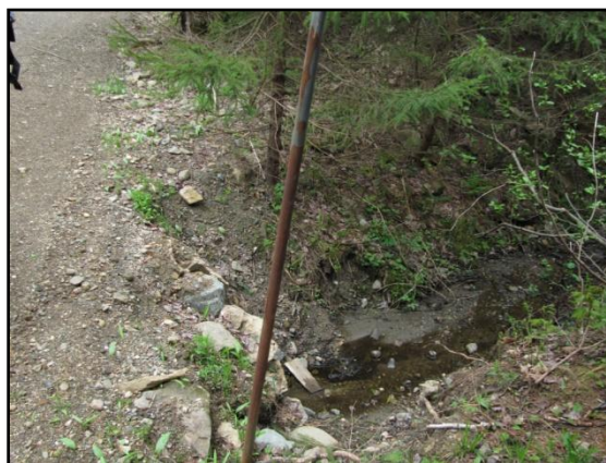
Point 7 : Talus du ponceau abrupt et instable.
