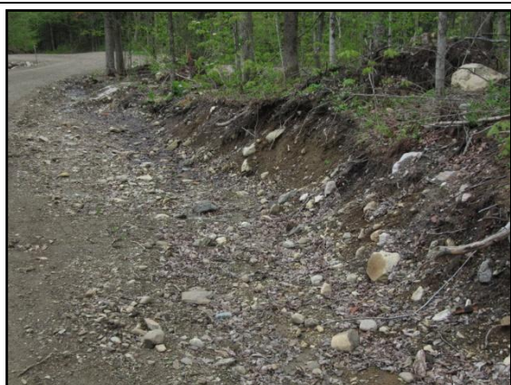
Point 4 : Érosion du fossé en amont du ponceau
