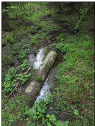
Point 12 : Tuyau de ponceau beaucoup trop long.
