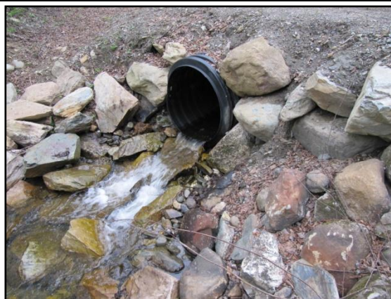
Point I : Cascade du côté aval du ponceau.
