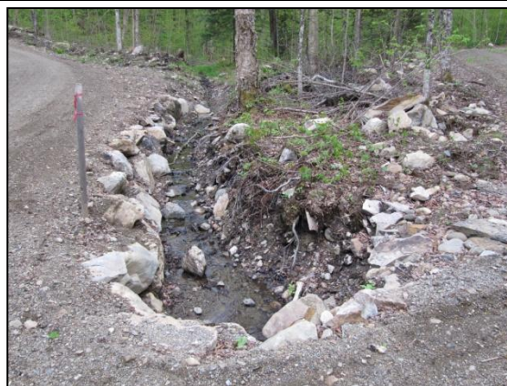
Point 3 : Érosion des talus du fossé à l'amont du ponceau.
