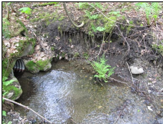
Point 15 : Affouillement de la berge du côté aval du ponceau.
