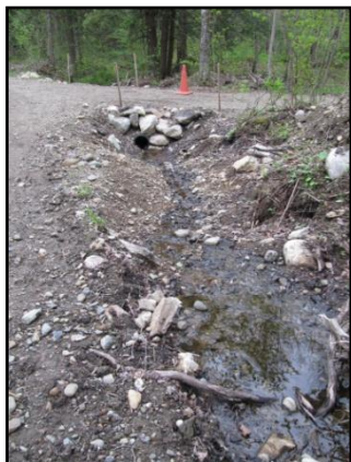
Point 3 : Érosion des talus du fossé non stabilisé.
