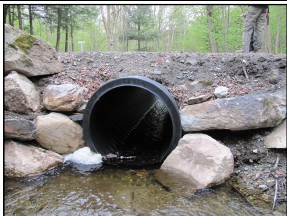
Point I : Haut de talus non stabilisé et effritement du gravier entre les pierres du bas du talus.
