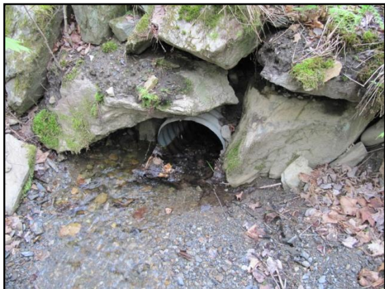
Point 15 : Accumulation de gravier du côté aval du ponceau.
