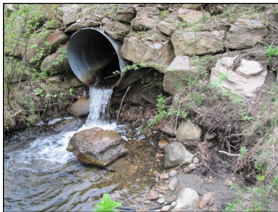
Point 13 : Chute empêchant la montaison du poisson.
