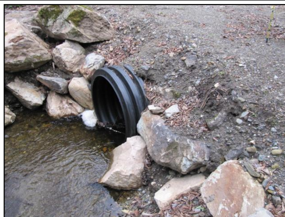
Point I : Haut de talus non stabilisé.
