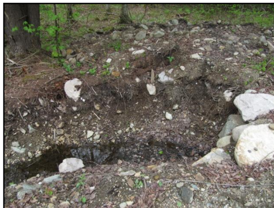
Point 3 : Forte érosion du côté aval du ponceau.
