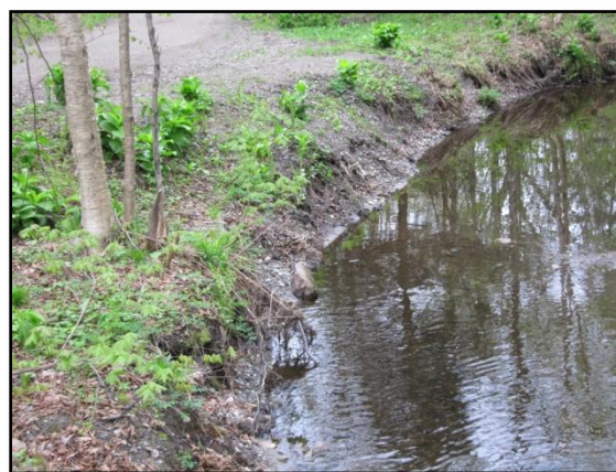
Point I : Début d'affouillement de la berge. Rive gauche du côté aval du ponceau.
